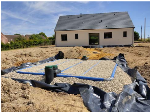
Figure 9 : Filtre à sable en cours de contrôle.
